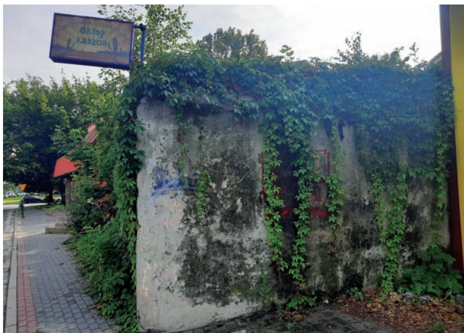
Fot. 2. Schron bierny piechoty typu Regelbau 701, Tomaszów Mazowiecki, ul. Wiejska (fot. M. Reczycki)
