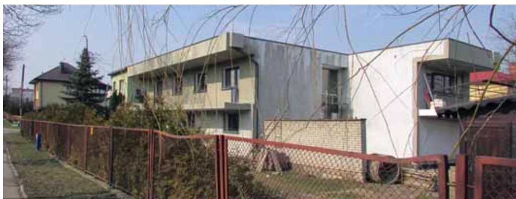
Fot. 15. Dom przy ulicy Zajęczej 29 w trakcie modernizacji, marzec 2015 (fot. S. Wicher)
